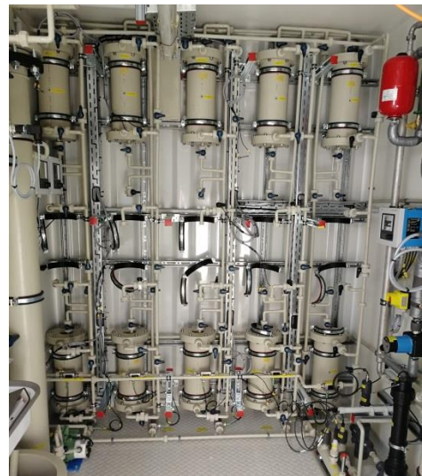
Abbildung 2: 10 der 15 Elektrolysezellen mit je 7 Litern Reaktorvolumen im Anlagencontainer
